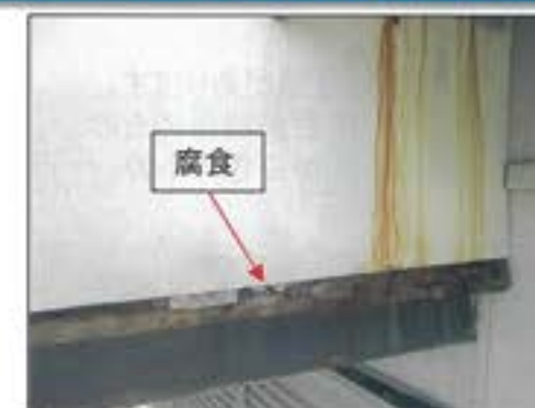
② 改修前の腐食状況
