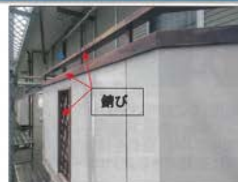
① 改修前の錆び状況
