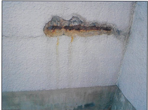
躯体内部のサビ
