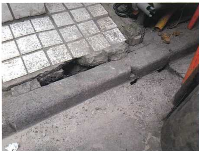
タイル土間スラブの陥没
