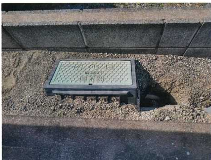
散水栓周りが沈下
